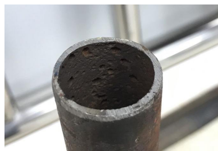
图3 脱戊烷塔空冷管束内部腐蚀情况
