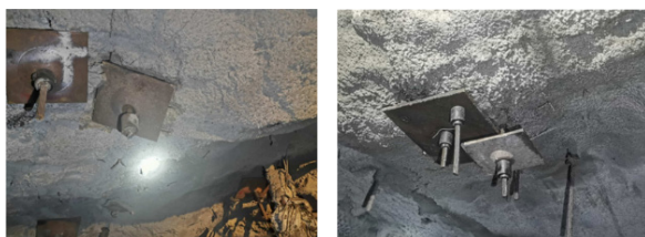
图 3 221303 材料顺槽失效锚索照片
