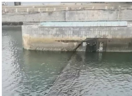
图 4 北方寒冷环境挡墙大理石脱落
