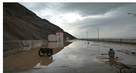
图1 降水1h后原右坝肩坝面积水情况(从东向西拍摄)
