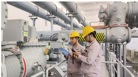
图2 水电站用电设备定期检查
