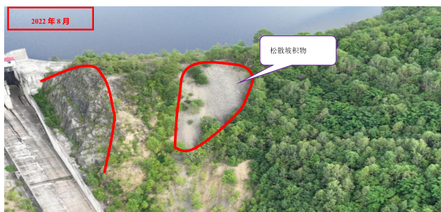
图 4 松山大坝左岸边坡及其左侧松散坡积物
