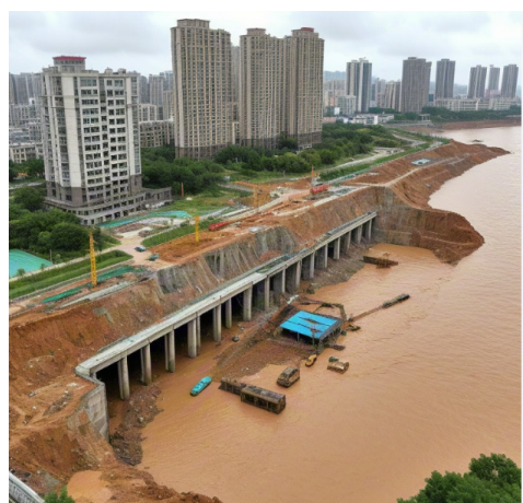
图1 地下水位变化对建筑工程稳定性影响实景图
