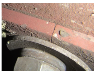
图1 螺栓孔单侧或双侧断裂
