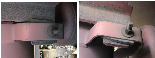
图5 风缸吊架与吊座间增设5mm厚橡胶垫
