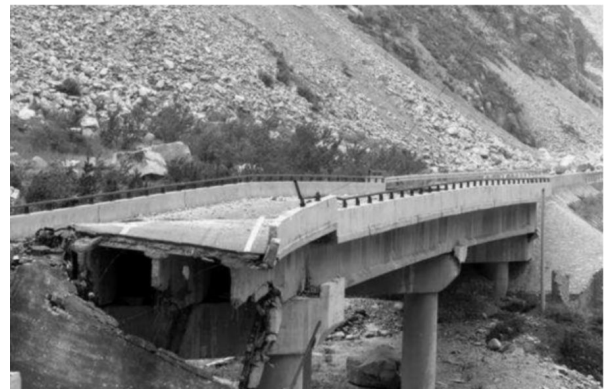
图 1 公路桥梁的上部灾害
