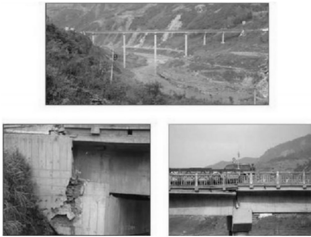
图2 公路桥梁基础受损图
