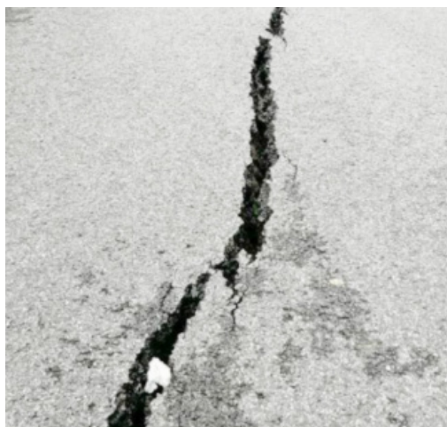
图 2 混凝土结构裂缝照片
