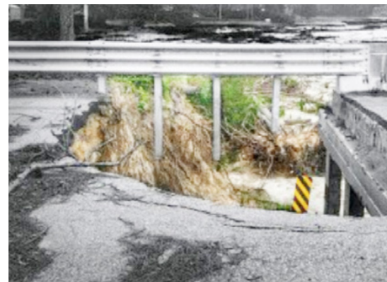
图 1 道路桥梁主体结构坍塌照片
